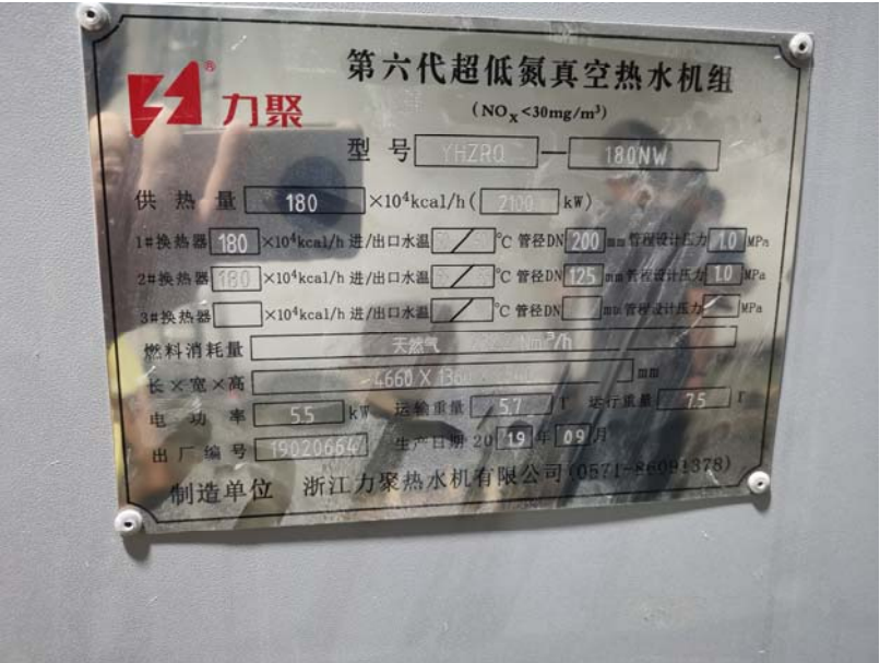
图 3-1 油烟净化器环保标识及超低氮锅炉铭牌
